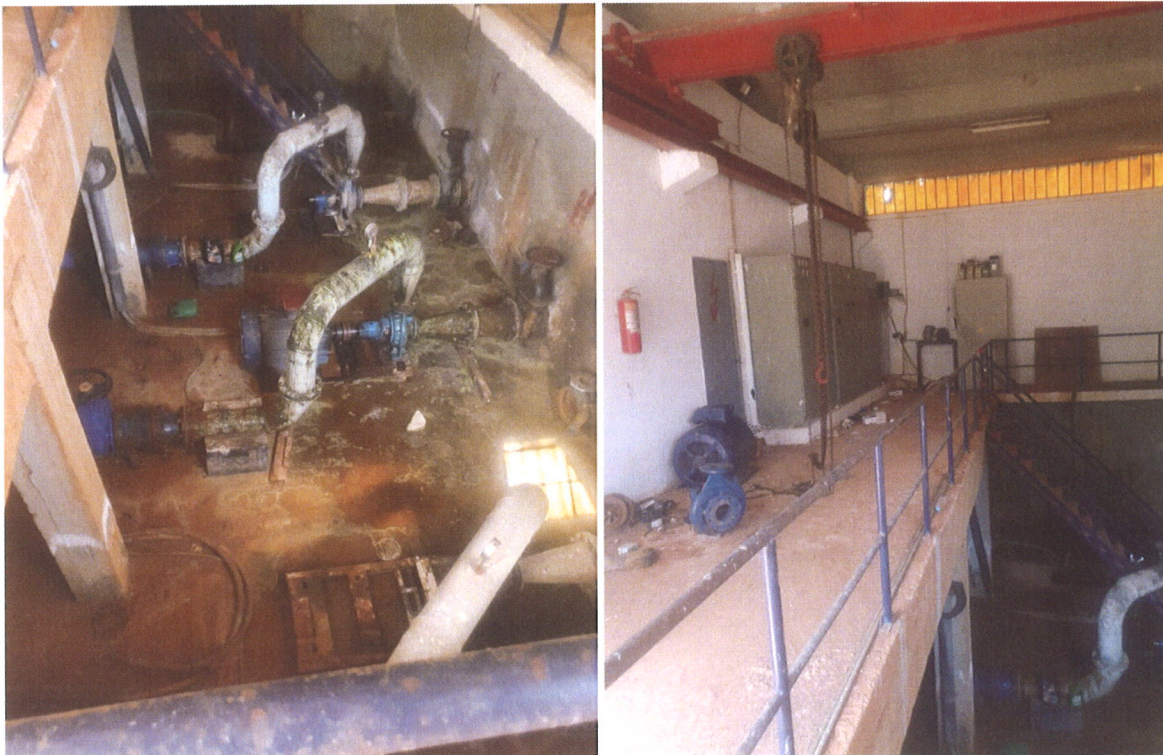
Φώτο 4. Άποψη από το εσωτερικό του αντλιοστασίου θέση Μαργωνέικα
