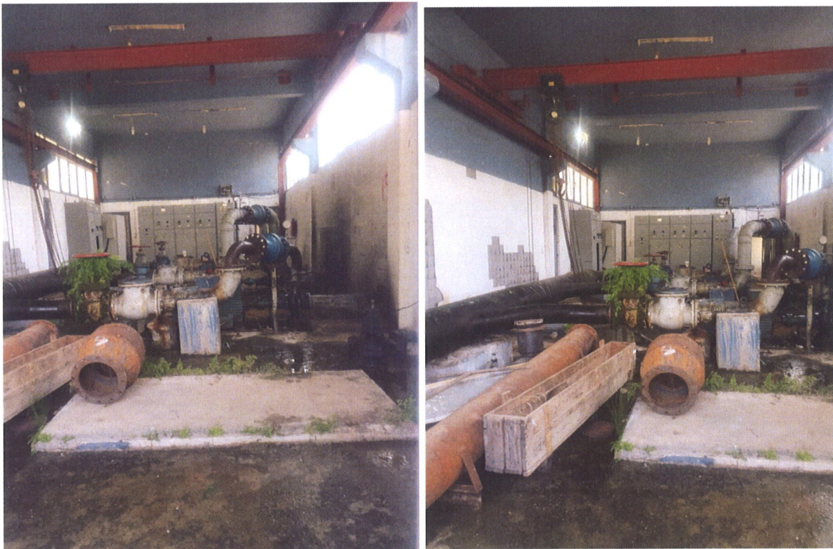
Φώτο 2. Άποψη από το εσωτερικό του αντλιοστασίου πηγών Αγ. Δημητρίου
