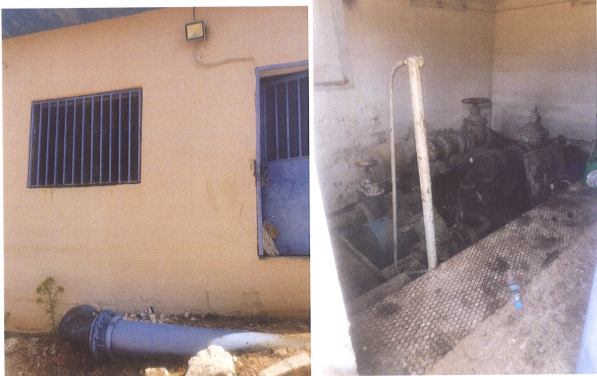
Φώτο 6. Άποψη από το εξωτερικό και εσωτερικό του αντλιοστασίου θέση Λιβανέικα
